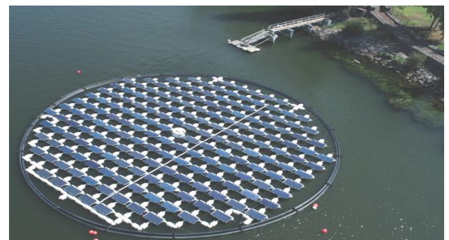
111年11月28日 追日的飄浮太陽能發電廠 https://buzzorange.com/techorange/2022/11/28/floating-solar-panels-follow-sun/
